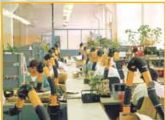
С-Петербург. ГУП СПб. Электротехнический завод. 12 настольных вытяжных устройств DELI, подключенных к центральной системе вентиляции.
