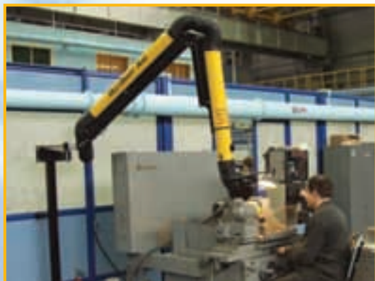
г.Электросталь. Завод "Элемаш", участок шлифовки. Вытяжное устройство MSA, установленное на опоре PA-220 для обеспечения вытяжки от шлифовального станка.
