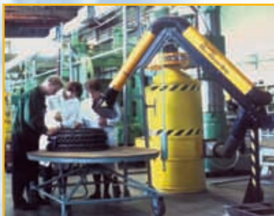
Пермь. ОАО "Пермский моторный завод". Местные вытяжные устройства MultiSmartArm производства Plymovent (Швеция).
