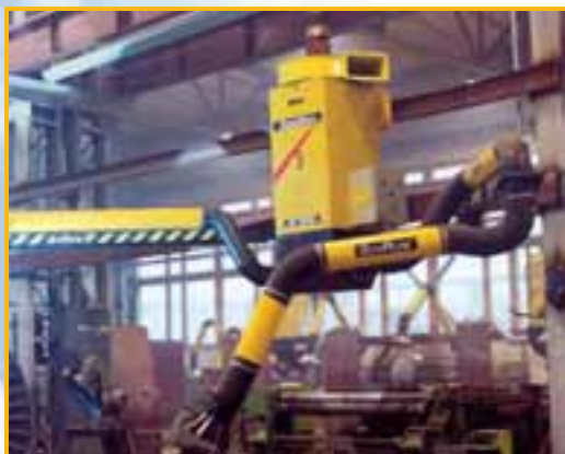
г. Пермь. Камкабель. Электростатический фильтр EF 5000 с подключением двух вытяжных устройств FLEX-MAX.
