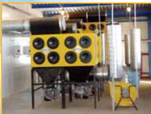
г. Санкт-Петербург. Чаеразвесочная фабрика. Горизонтальное расположение нескольких модулей фильтра MDB (В-8-Н).
