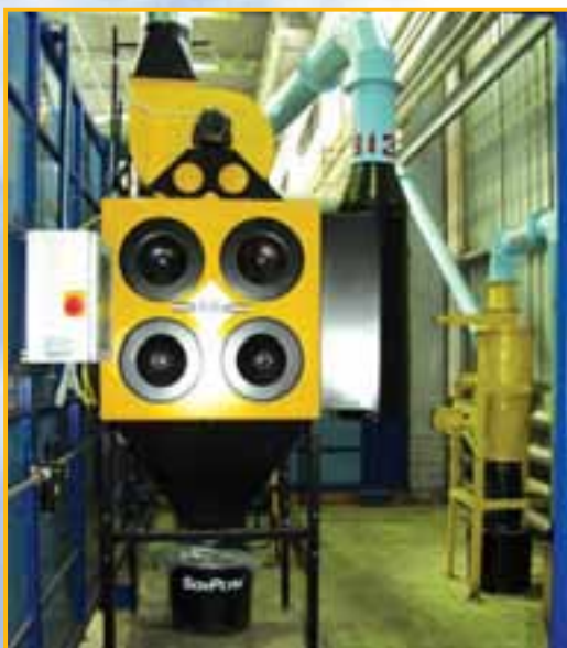
г. Электросталь. Завод "Элемаш". Участок заточки. Базовый модуль ВМ-4 фильтра с прямой установкой вентилятора на фильтр MDB.
