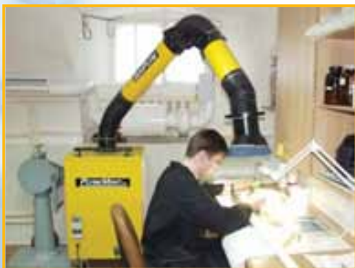
г. Санкт-Петербург. Кунтскамера. Фильтр MFC-1000, с вытяжными устройствами KUA-S.
