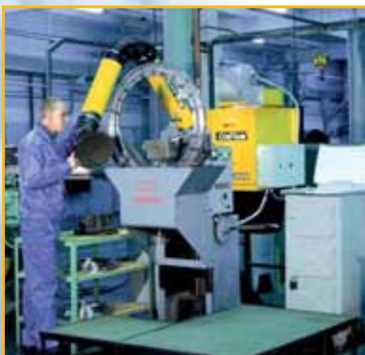
Пермский моторный завод. Электростатический фильтр EFO с вытяжным устройством КУА для улавливания загрязненного воздуха и очистки от масляного тумана.
