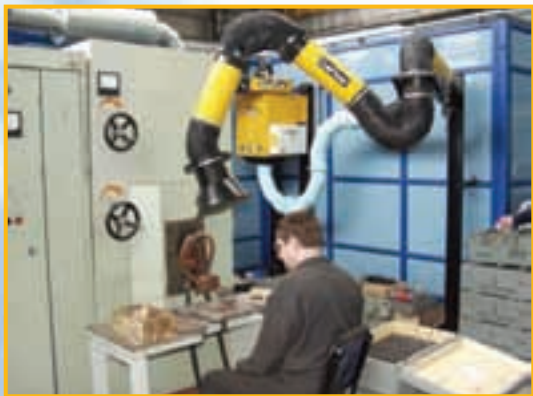
г.Электросталь. Завод "Элемаш", участок наплавки. Вытяжное устройство FLEX-MAX, установленное на опоре РА-220 подключенное к фильтрвентиляционному агрегату EF.
