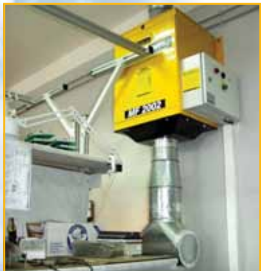
г. Москва. АО "Борец". Механический фильтр MF в составе местной вытяжной вентиляции.
