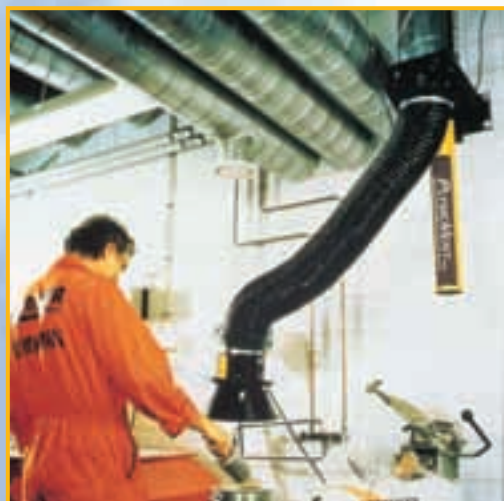
LM-2 установленное на стене и подключенное к системе центральной вентиляции
