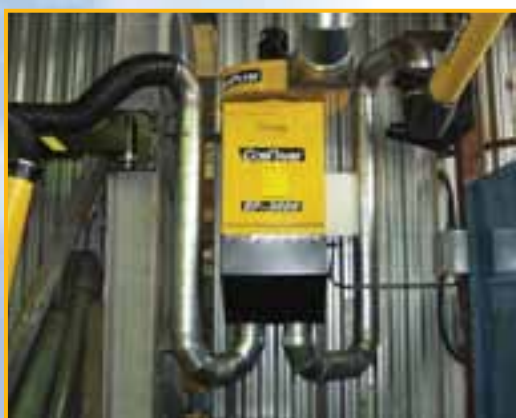
Фильтр EF-3000 с подключением двух вытяжных устройств.
