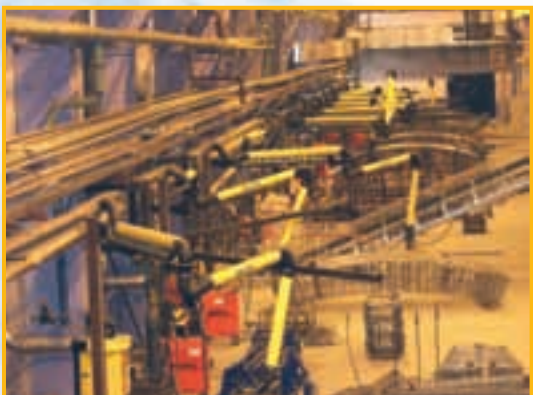
г. Москва. Завод №18 АО "Моспромжелезобетон". Рабочие места оснащены вытяжными устройствами FM 3540, FM 2540.
