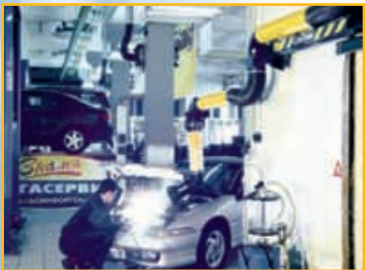
г. Санкт-Петербург, СТО "Мега-сервис". Консольно-поворотное вытяжное устройство FLEX-MAX, подключенное к центральной вентиляции.
