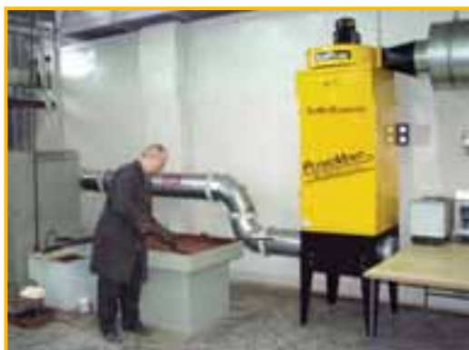
г. Электросталь. Завод “Элемаш”. Участок термообработки. Фильтр МЕ .
