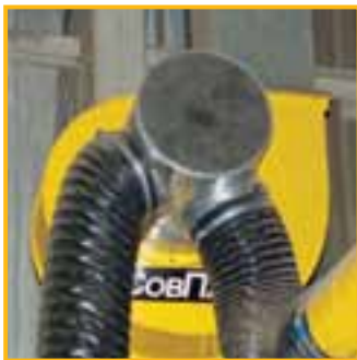
Установка тройника для подключения двух вытяжных устройств.
