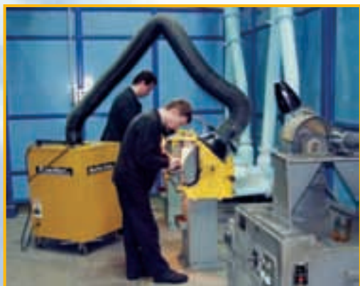
г.Электросталь. Завод "Элемаш", участок заточки. Вытяжное устройство EA.
