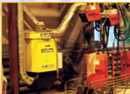
г. Москва. Завод №18 АО "Моспромжелезобетон". Оснащение сварочного участка фильтром EF-2000.
