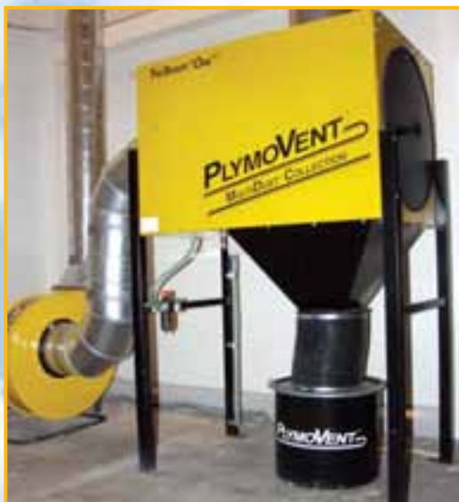
г. Санкт-Петербург. Завод "Форд". Фильтр S1 с влагомаслоотделителем и индивидуальным вентилятором.
