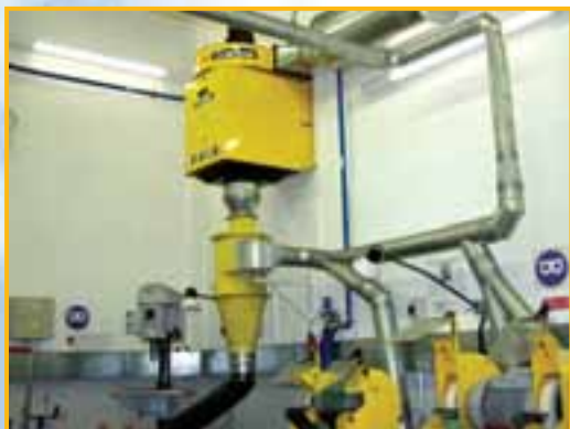
г. Санкт-Петербург. Завод "Форд". Участок механической обработки. Фильтр MF с фильтром предварительной очистки.
