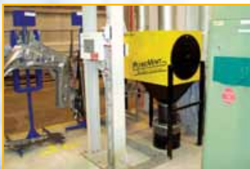
г. Санкт-Петербург. Завод "Форд". Участок точечной сварки. Фильтр S1 с подключением к системе местной вытяжной вентиляции.
