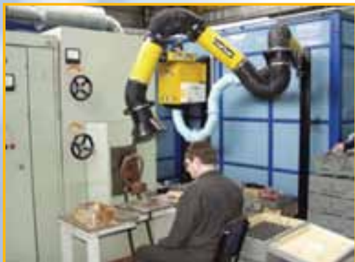
г. Электросталь. Завод "Элемаш". Участок наплавки. Механический фильтр MF с подключением к вытяжному устройству Flex-Max.
